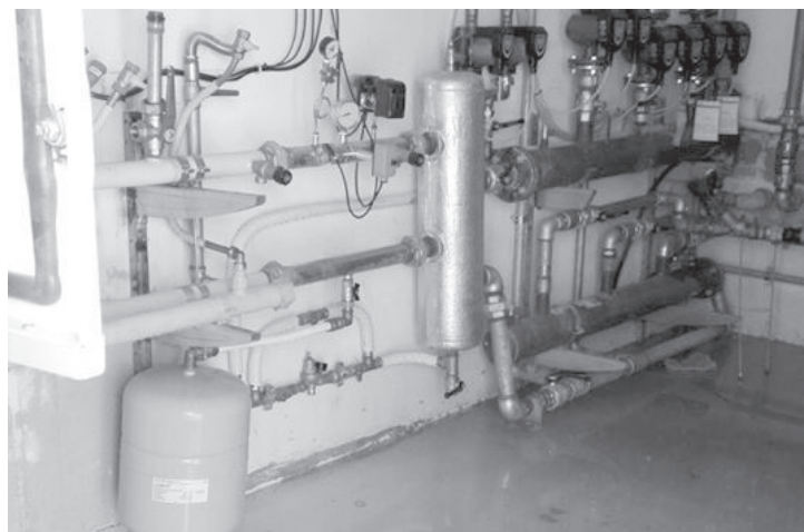
In alto: la stanza delle caldaie. A lato: il sopralluogo degli investigatori
